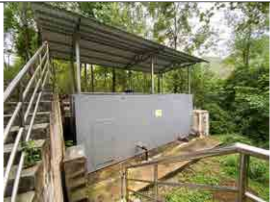
一体化生活污水处理设施
