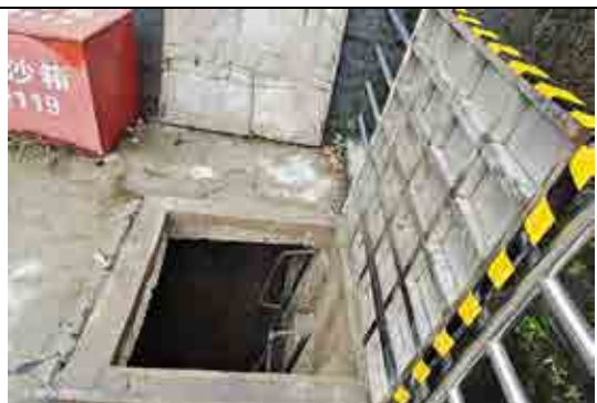
厂房内事故油池 30m 3
