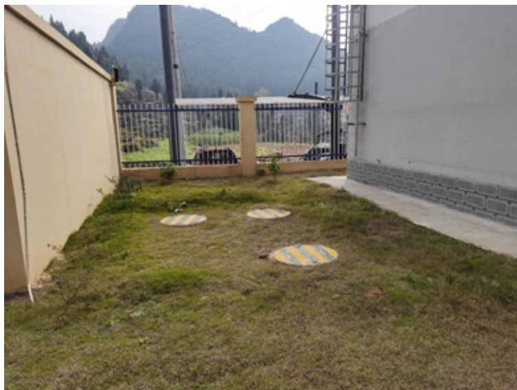
生活污水处理设施
