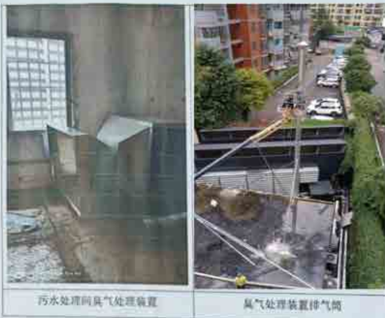
污水处理站臭气处理装置 臭气处理装置排气筒
