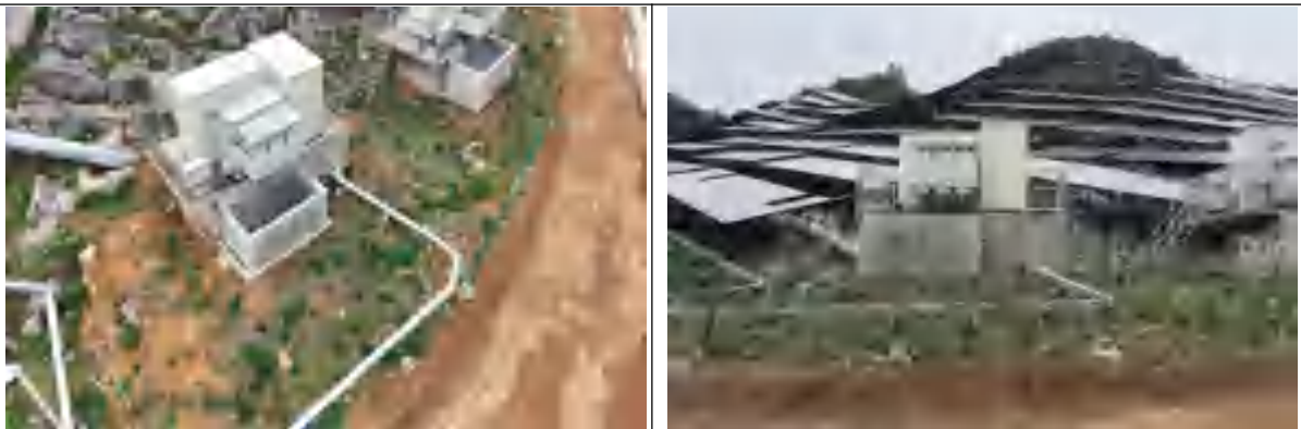
光伏场区箱式变压器事故油池
