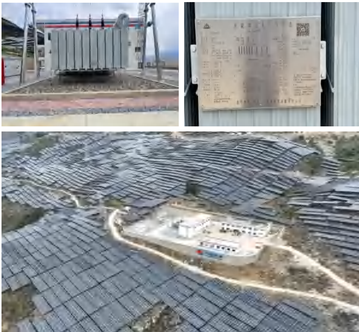
110kV 升压站现状
