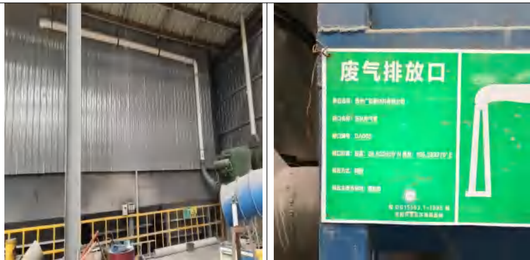
料仓废气及压机排气筒
