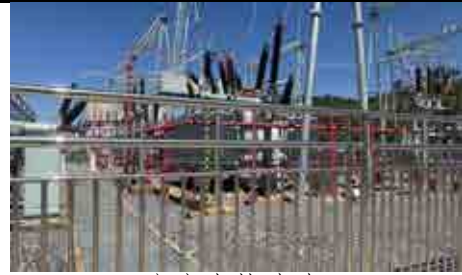
主变事故油池
