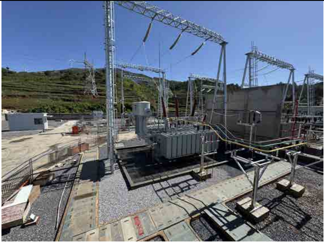
项目升压站主变
